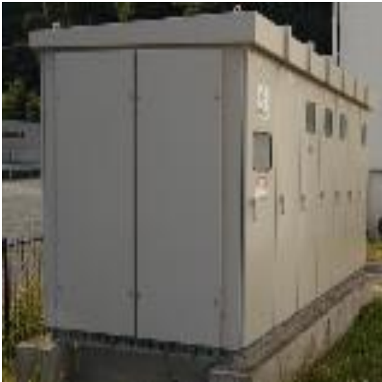
キュービクル増設あり
